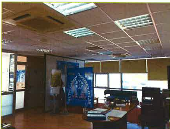
Fotografía Nº1. Unidades Interiores de climatización
