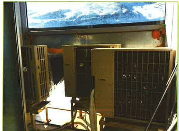
Fotografía Nº2. Unidades exteriores de climatización
