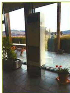
Imagen 1. Instalación climatización de planta baja.
