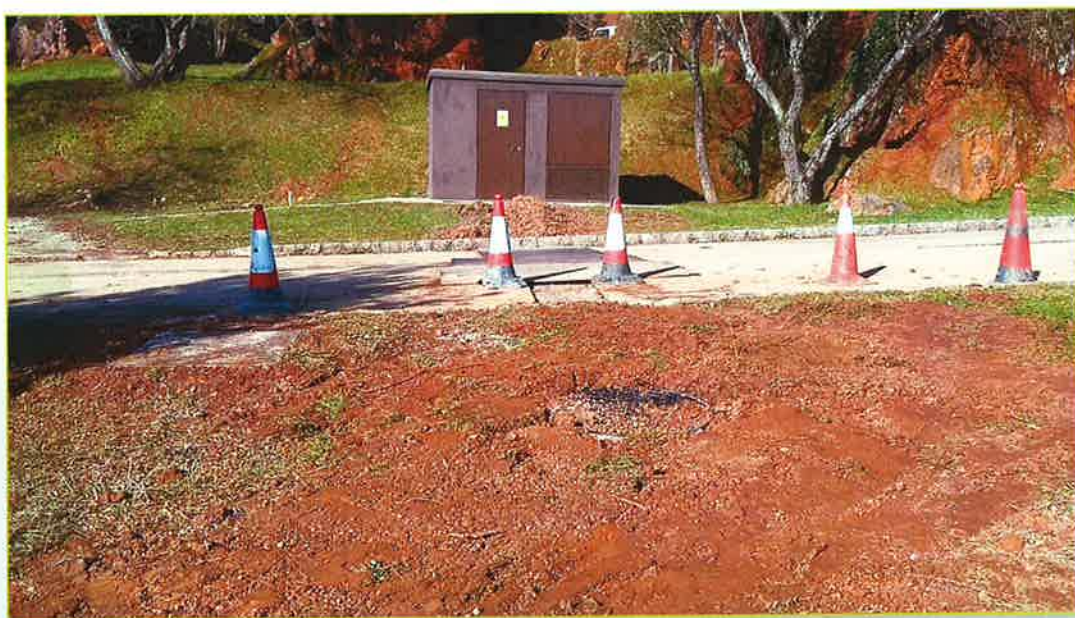
Foto Nº2.- Ormazábal del "CT Hienas", desde el cual se distribuye las Líneas de BT hacia los recintos de Jirafas y Osos.
