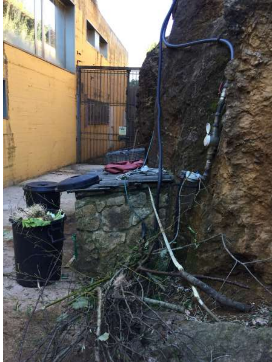
Fotografía 49. Infraestructura de abastecimiento actual a edificio Gorilas desde depósito.
