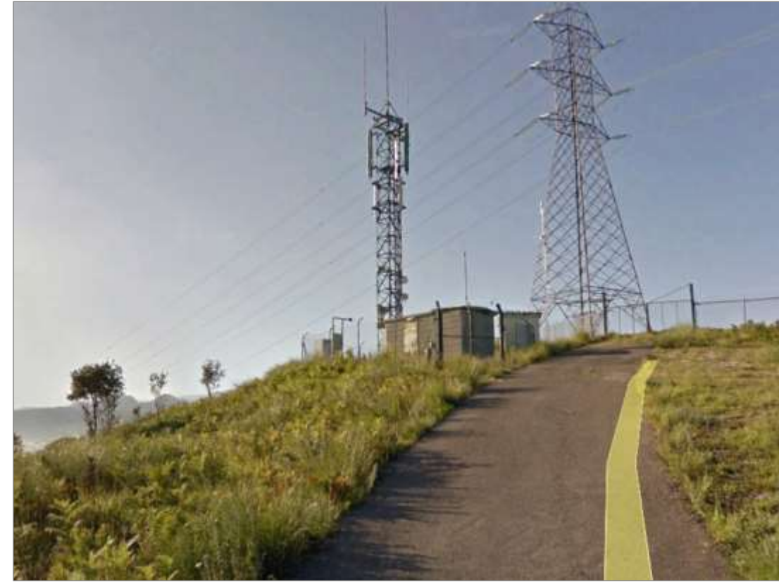
Fotografía 27. Trazado de nueva infraestructura de fibra óptica y electricidad BT por centro de calzada.
