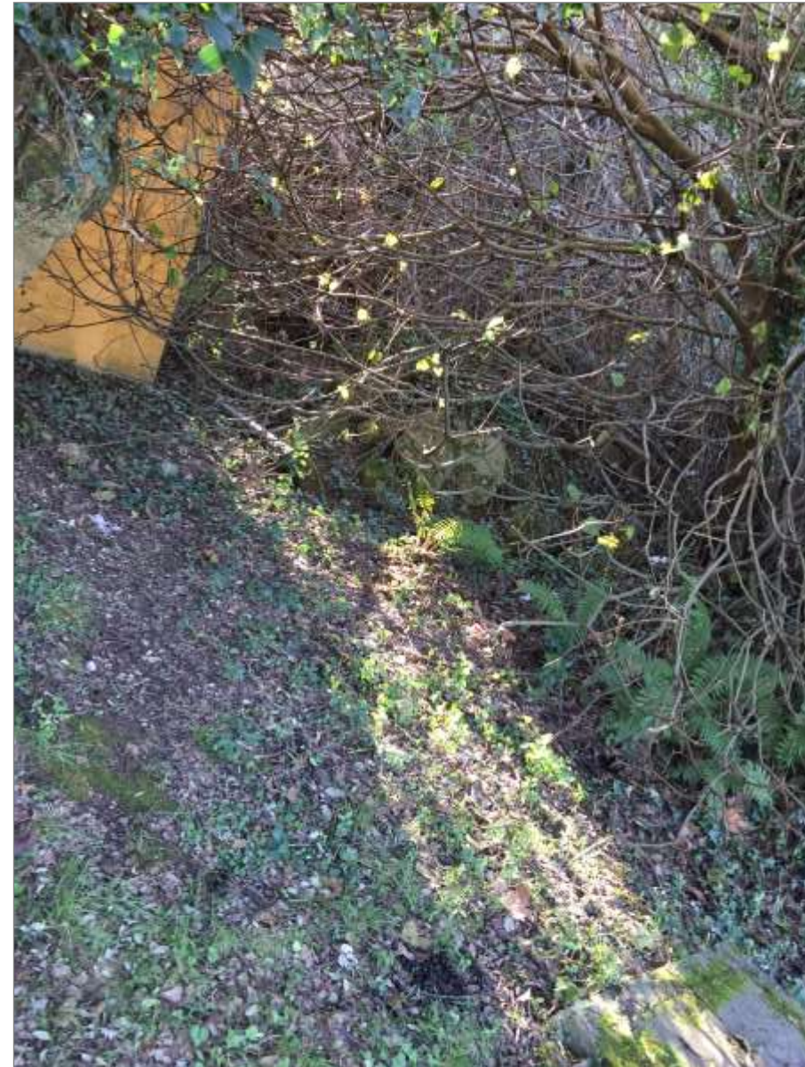
Fotografía 55. Continuidad del colector de saneamiento actual por detrás de la Cafetería Gorilas, hacia arqueta existente.
